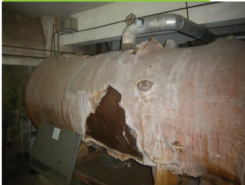
Caldera, Hospital de Salta
